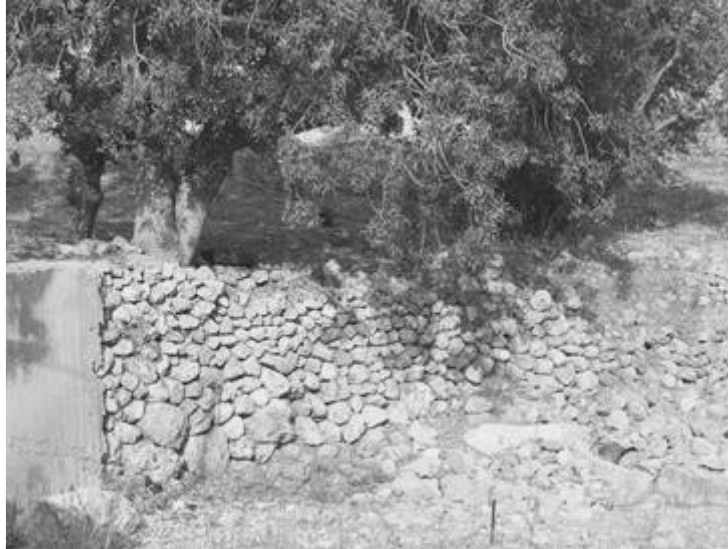
Εικ. 40: Τοίχος αντιστήριξης από ξηρολιθοδομή σε κοίτη χειμάρρου στα ανατολικά του Κάστρου της Χώρας. Αριστερά διακρίνεται η σύγχρονη παρέμβαση με τοίχο αντιστήριξης από σκυρόδεμα (2019).
