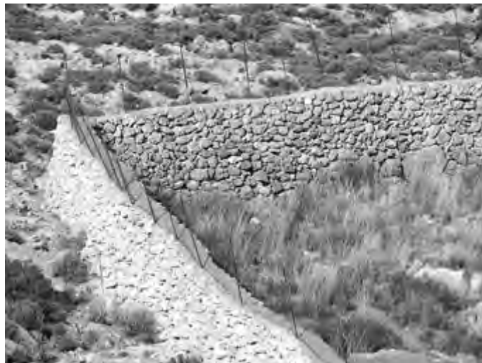
Εικ. 27: Σύγχρονη κατασκευαστική λύση για φράχτη περίφραξης κτήματος, δίπλα από τις εγκαταστάσεις του μοναστηριού της Αγίας Αικατερίνης. Ο φράχτης είχε κυμαινόμενο ύψος από 1,40 – 1,55 μ., βάση πλάτους 1,00 μ. και επίστεψη τσιμέντου πλάτους 0,52 μ. (2018).
